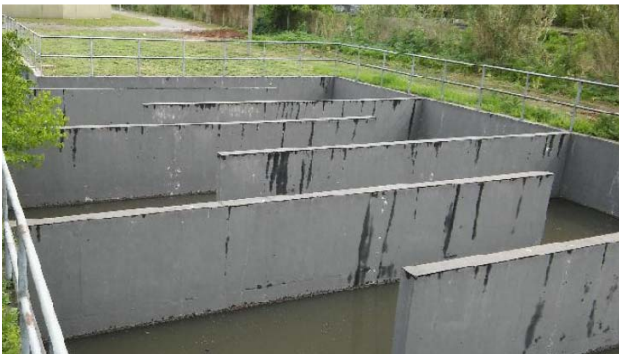
Figura 15: Cámara de contacto. Vegetación muy cercana a las instalaciones.
