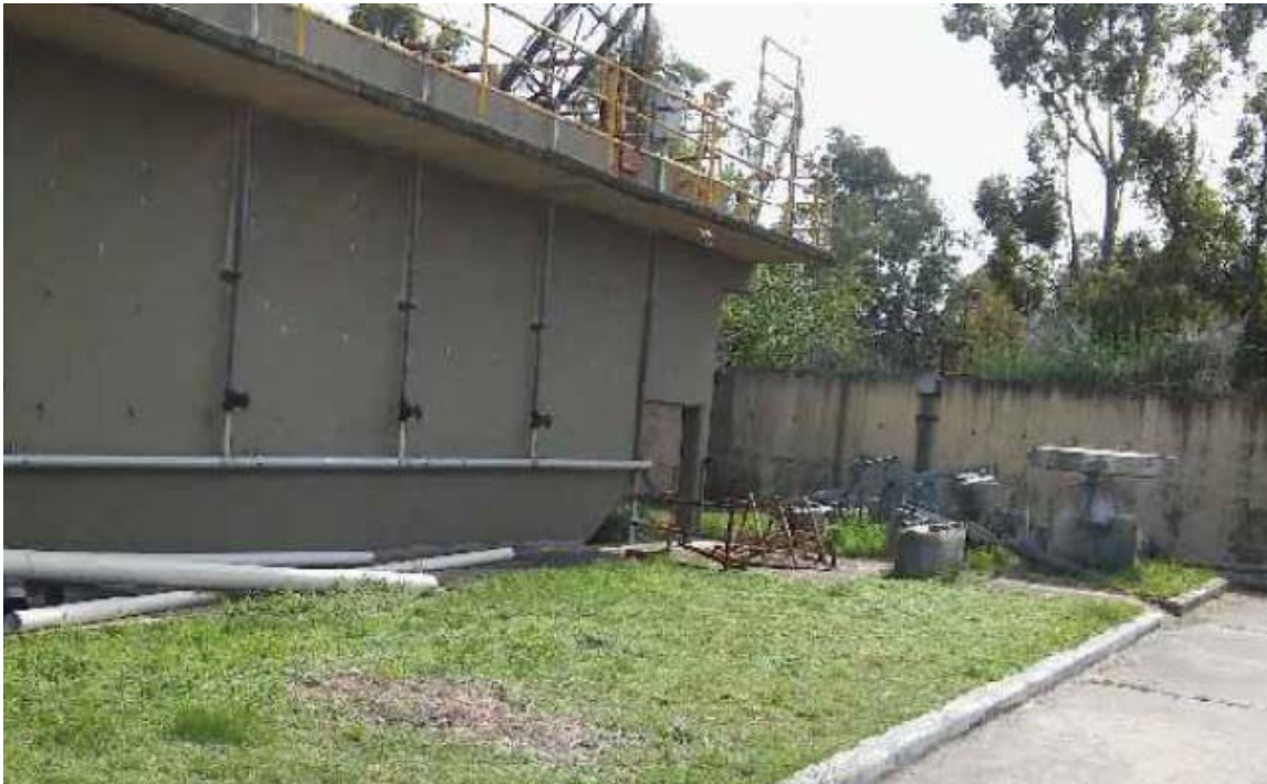
Residuos sólidos y aireadores en Desarenador
