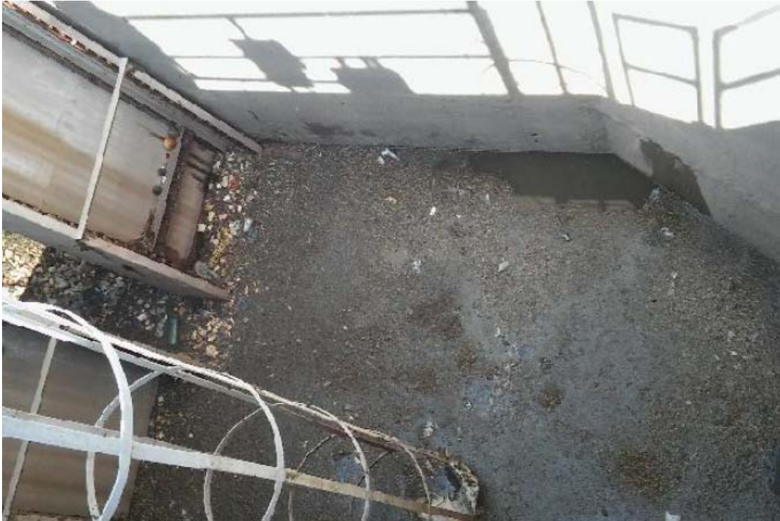
Líquido cloacal y sólidos en rejillas desarenadoras
