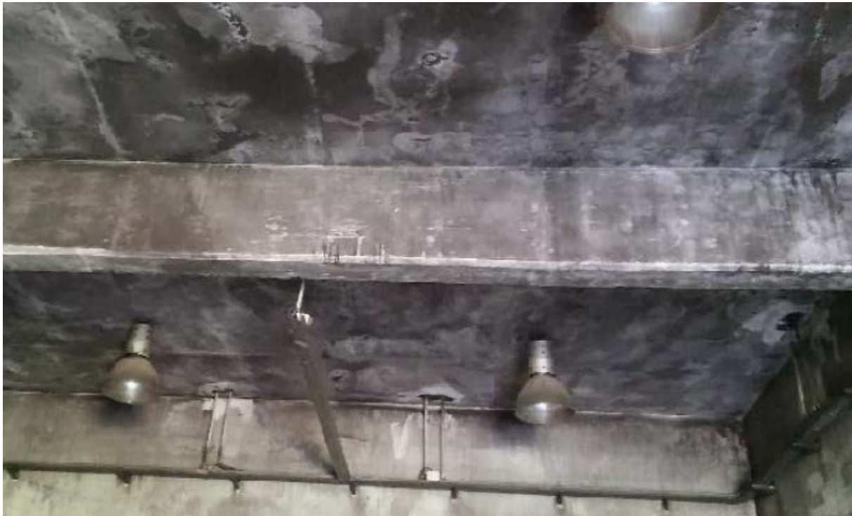
Techo quemado en depósito
