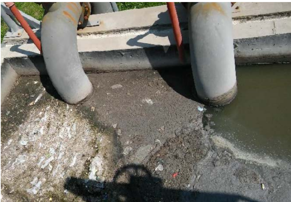
Desarenador con líquido cloacal y flotantes
