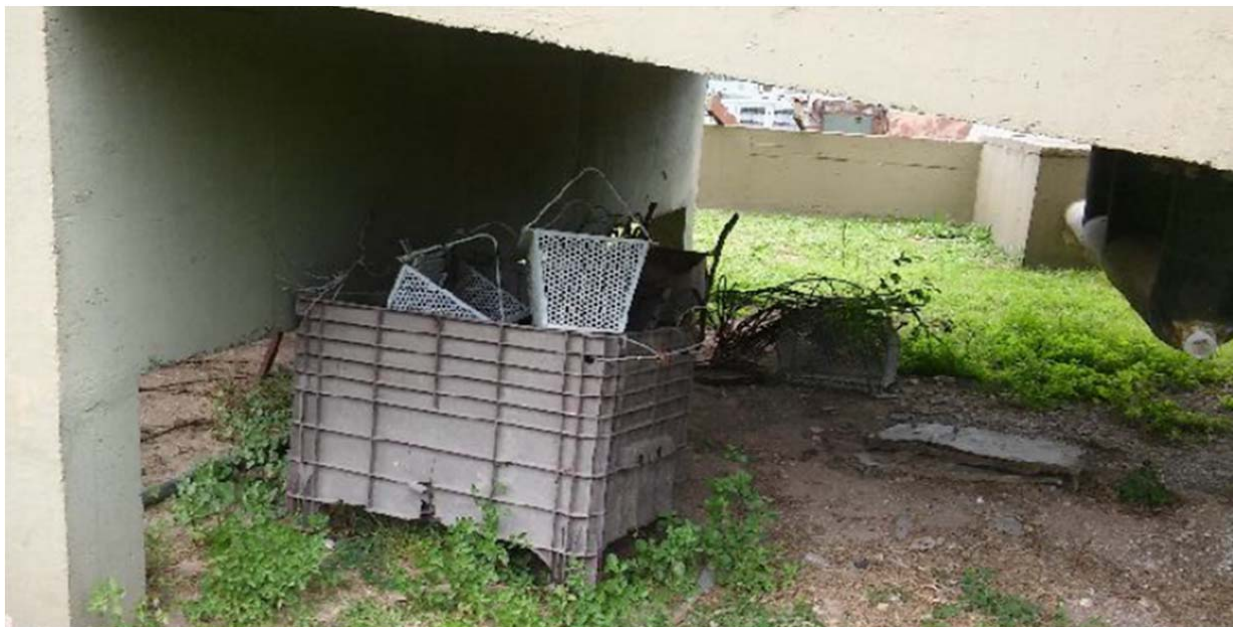
Figura 16: Chatarra en el Desarenador
